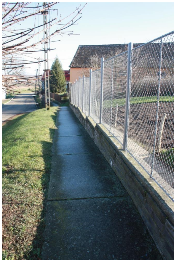
Dilatált beton járda a Csele utcában
